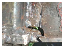
梁亀裂・破断
